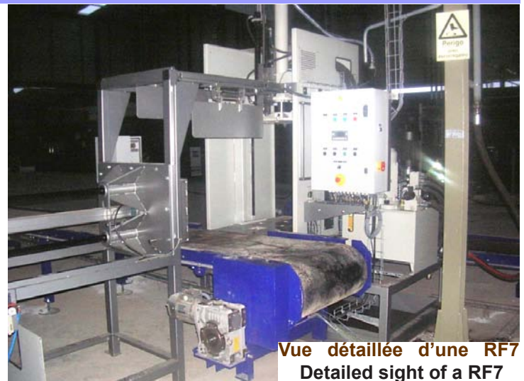
Vue des 3 postes RF7 together of 3 RF7
